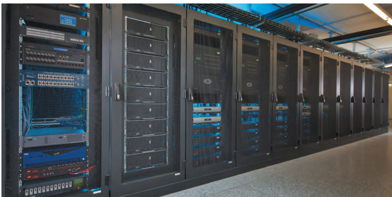
Blick in den zentralen Technikraum
